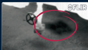
生産現場からのガス漏れを捕捉
