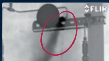
圧力計からの漏出
