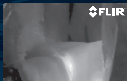
バルブから漏れを特定
